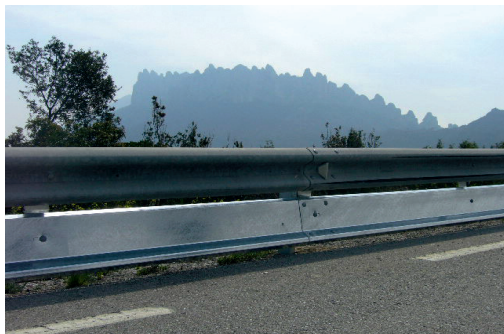
Sistema de Protecció per a Motoristes (SPM) instal·lat a la carretera BP101 a El Bruc
